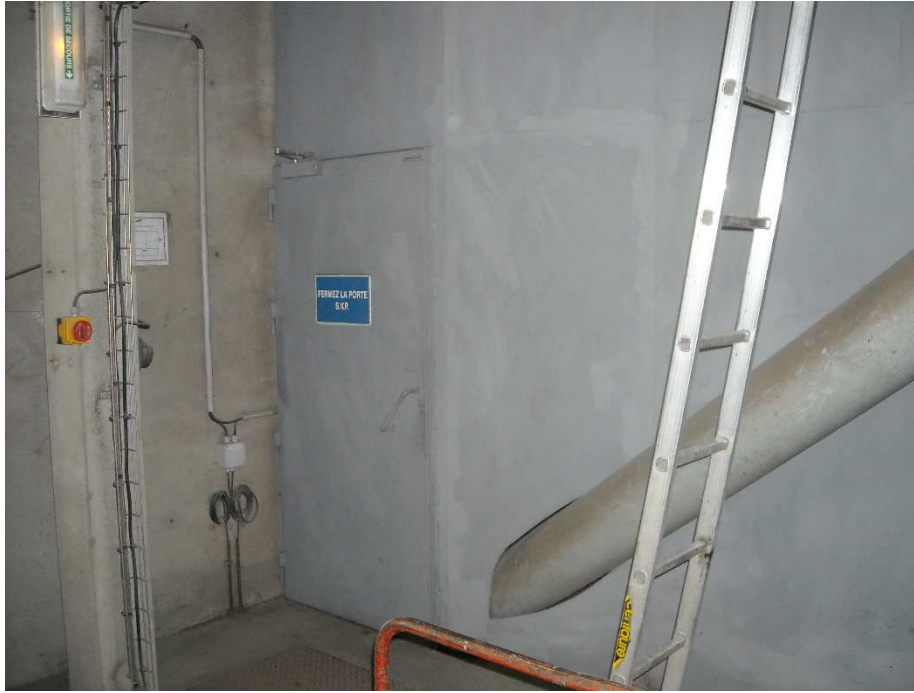
Porte de découplage dans un silo
