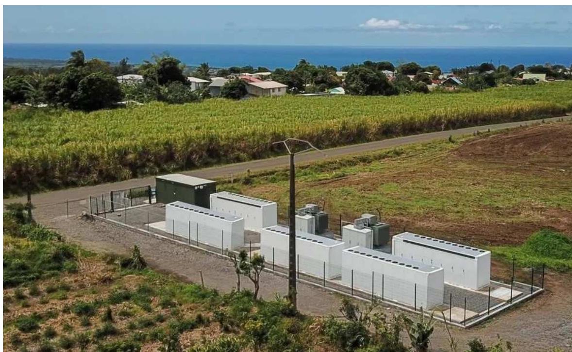
Installation à la Réunion © Tesla
