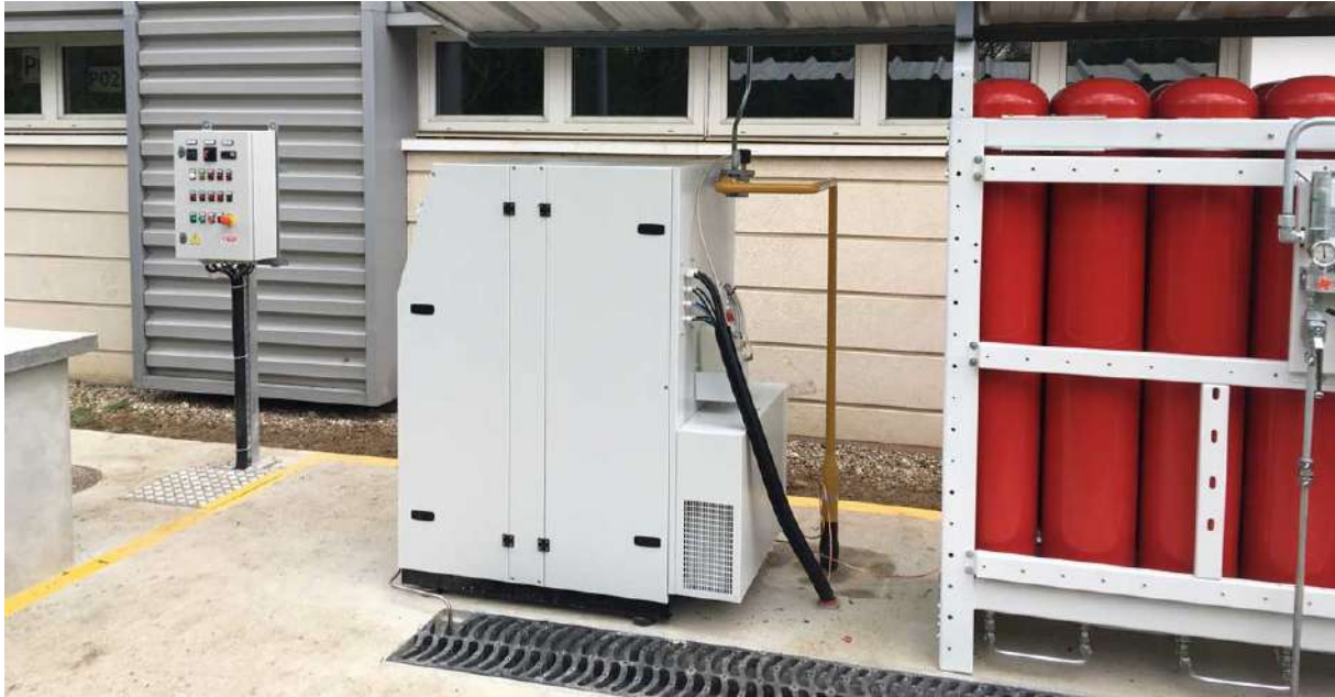
Unité de stockage © Gaz-mobilité
