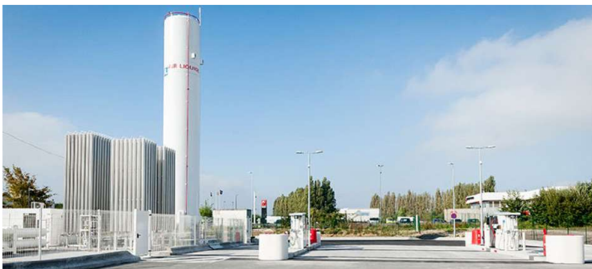
Installation de remplissage en GNL © Air Liquide
