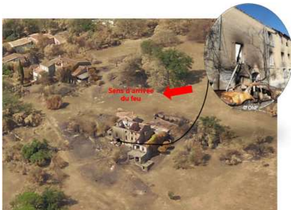
Maison non entretenue, avec des volets en mauvais état dont certains restés ouverts. La végétation accolée et les stockages divers au contact ont favorisé la destruction de la construction malgré sa situation hors zone forestière. © SDIS 83
