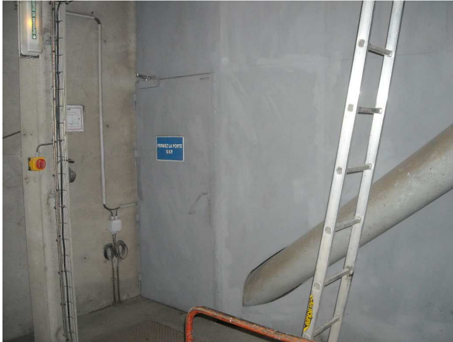
Porte de découplage dans un silo
